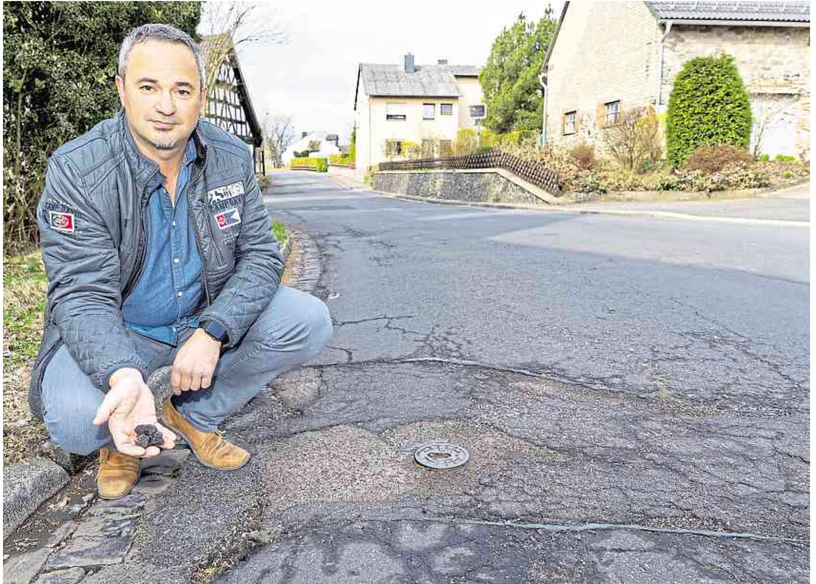
Die rund einen Kilometer lange Ortsdurchfahrt ist in einem desolaten Zustand. Ortsbürgermeister Holger Bäcker sagt: Sie muss dringend saniert werden. Die Frage ist, ob bis dahin das umstrittene Landesstraßengesetz geändert wird.
